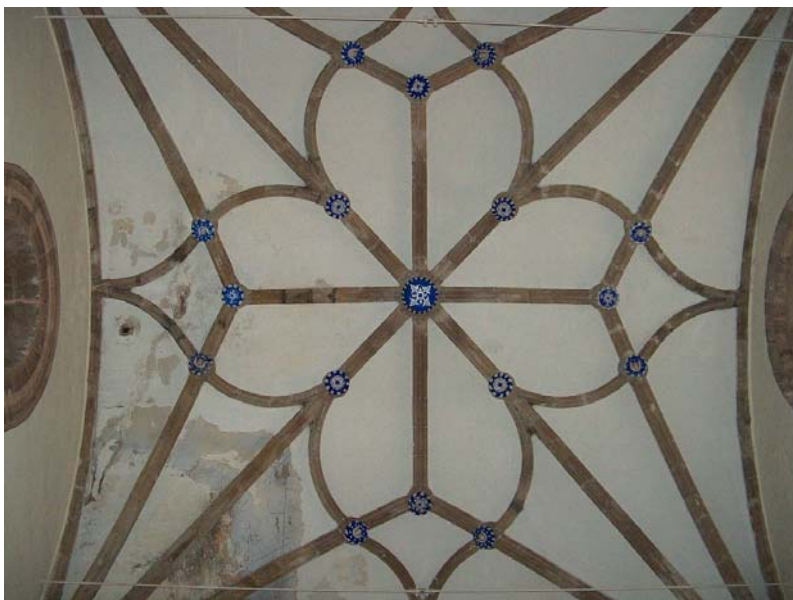
Fig. 3. Patologías de las bóvedas de la iglesia de San Blas. Interior.
